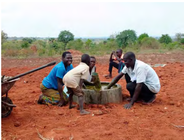
Uganda: gemeinschaftliches Befüllen der Biogasanlage
