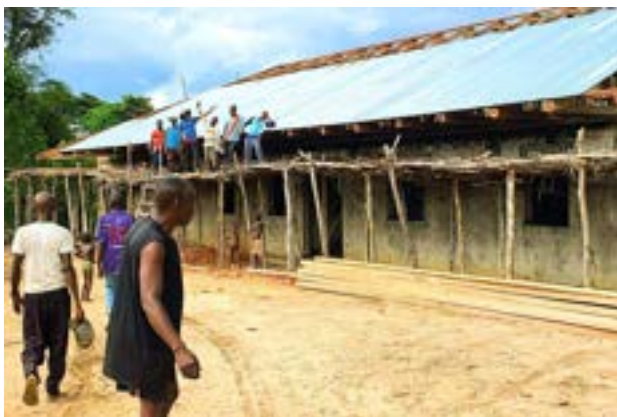
Eltern beim Dachdecken der Schule in Mondombe, die bereits teils renoviert ist.
