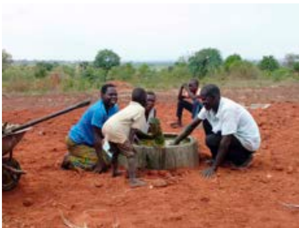
Uganda: gemeinschaftliches Befüllen der Biogasanlage
